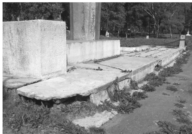
Разрушение основания мемориального комплекса «Скорбящая мать» у Братской могилы 124 партизан (г.Николаевск-на-Амуре). Целостности конструкции угрожает разрушение бетонного монолита.
